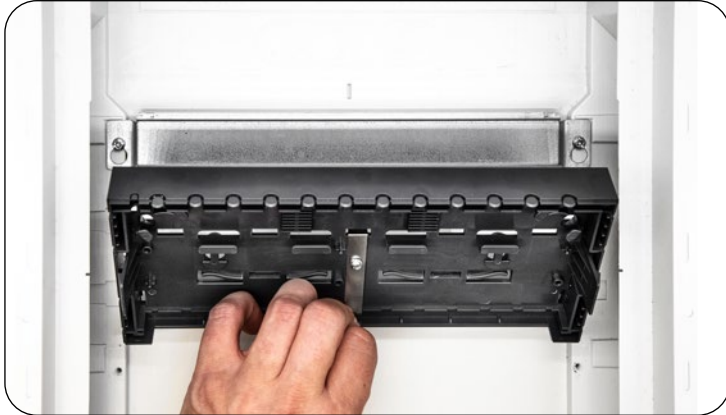
Abb. Montage im Multimediaverteiler
